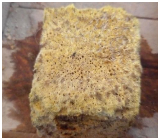
Figure 10. Gonflement d'une éprouvette en béton
